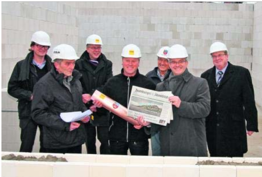
Landrat Michael Roesberg (zweiter von rechts) ließ bei der Grundsteinlegung auch ein Hamburger Abendblatt einmauern.
